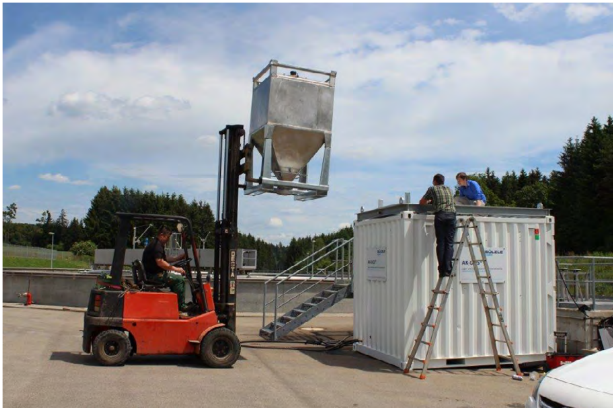
Abbildung 1: Aufbau der Pulveraktivkohledosieranlage auf der Kläranlage Emmingen (Bildquelle IB JuP)
