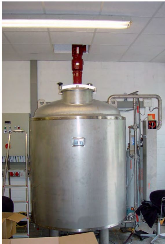
Edelstahltank (2,1m 3 ) zur Pasteurisierung von Abwasser, Grund- und Trinkwasser
