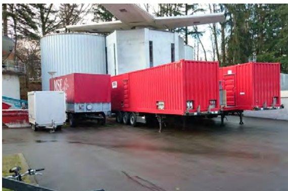
Abbildung: Mobile Phosphorrückgewinnungsanlage
