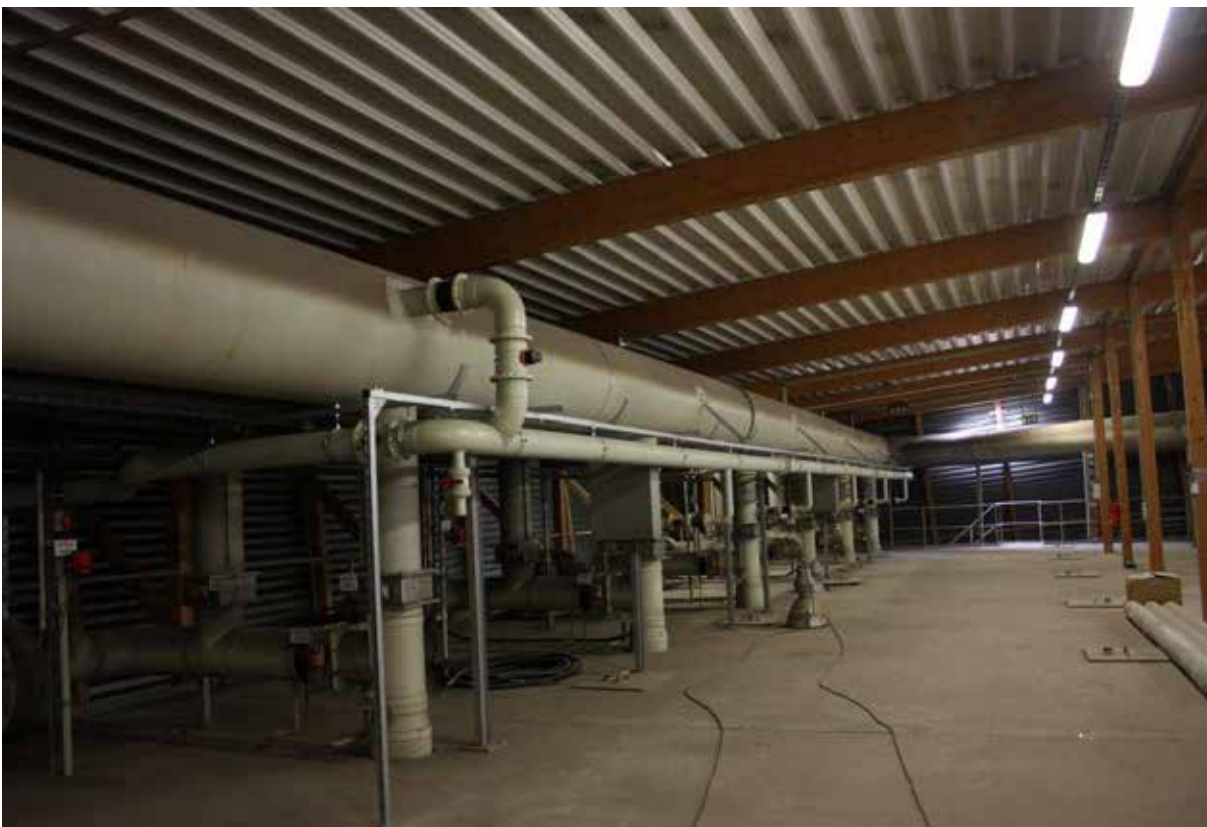
Neuer Abluftsammlerbalken für die Versorgung der Versuchsanlage mit verschiedenen Abluftzusammensetzungen
