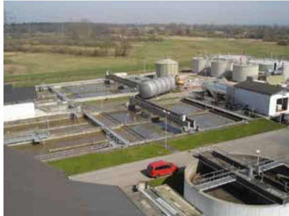
Abb.: Vorklärbecken, Blockheizkraftwerk und Biogasanlage der Gemeinschaftskläranlage Baden-Baden - Sinzheim
