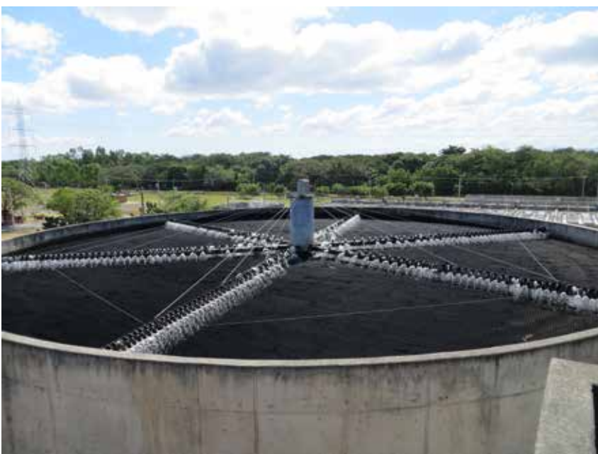
Abb.: Tropfkörper der kommunalen Kläranlage von Managua
