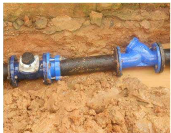
Abb.: Rohrstrecke mit Durchfluss- und Druckmessung
