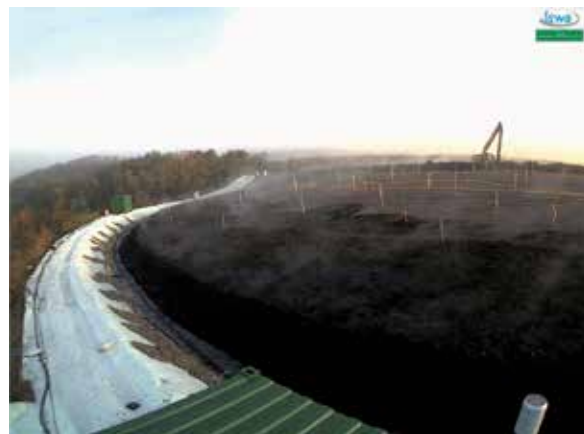
Teilbereich der Deponie Dorfweiher mit Belüftungslanzen während des Aufbaus des Biofilters
