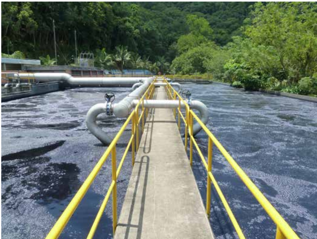
Abb.: Industriekläranlage der Textilveredlungsfirma Malwee
