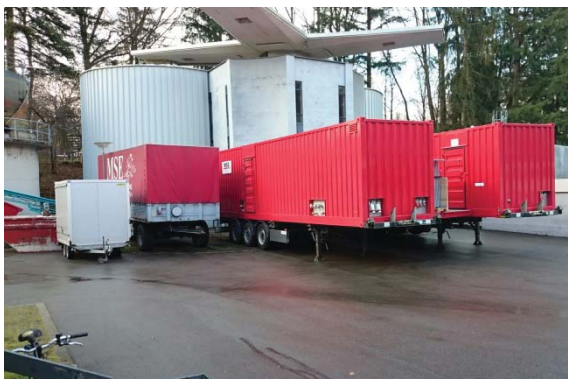
Abbildung: Mobile Phosphorrückgewinnungsanlage
