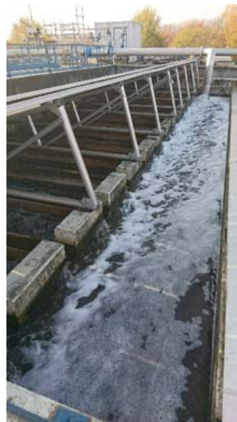
Filter in Betrieb (rechts) (Quelle: KomS)
