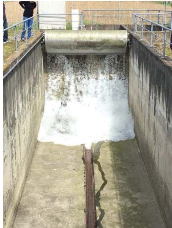
Abb.: Einsatz einer Spülkippe im Regenüberlaufbecken
