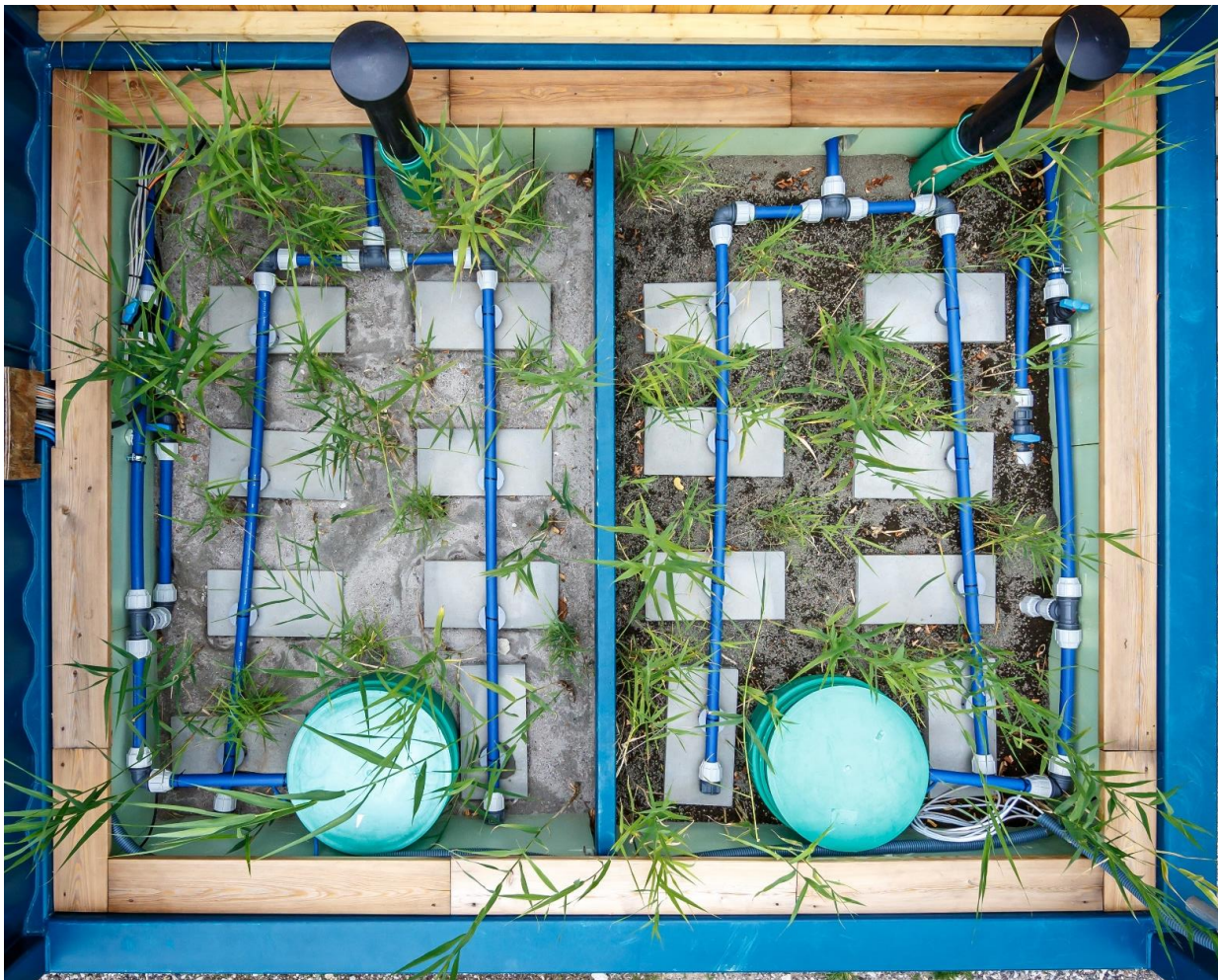
Abb. 1. Vertikal durchflossener bepflanzter Bodenfilter im Pilotmaßstab zur Behandlung von schwach belastetem Grauwasser. Sand 0 mm bis 2 mm (links) und Lavasand 0 mm bis 4 mm (rechts) als Filterschicht. Kulturschutzgebiet Wagenhallen in Stuttgart
